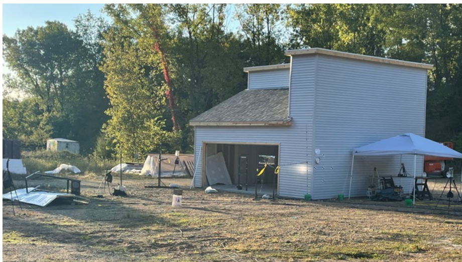
Observez l'emplacement de la porte après la déflagration.
